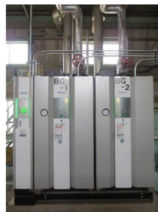
小型ボイラー 1 号機、2 号機
