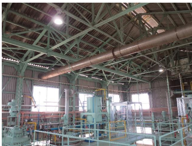
3工場LED照明の様子
