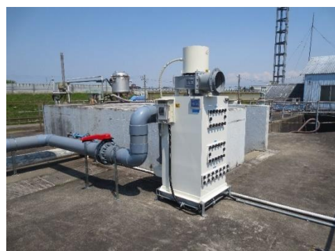
廃水処理場 脱臭装置
