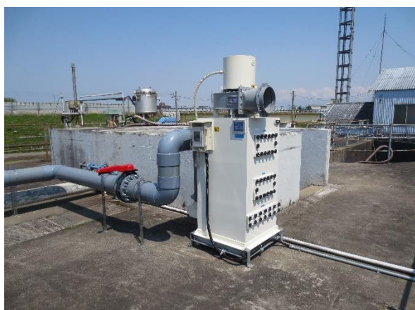
2021 年 12 月 脱臭装置を設置
