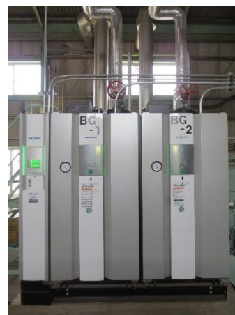
小型ボイラー 1号機、2号機
