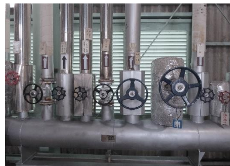
各方面への蒸気供給元バルブの様子
