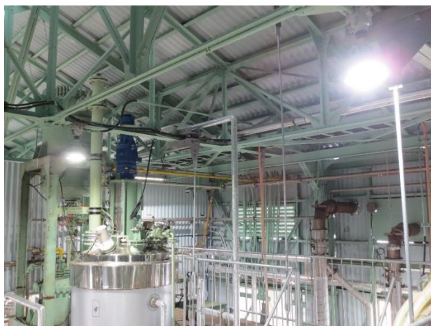
1工場 LED 照明の様子
