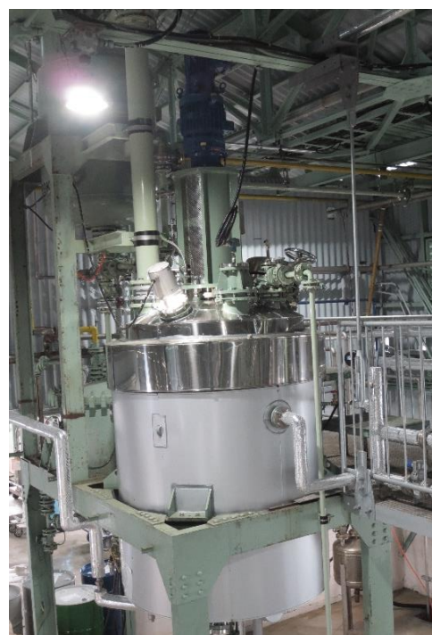
ガラスライニング製 1500L 反応蒸留釜
